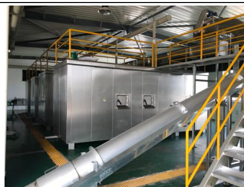
淳溪街道餐厨垃圾处理项目内部设备
