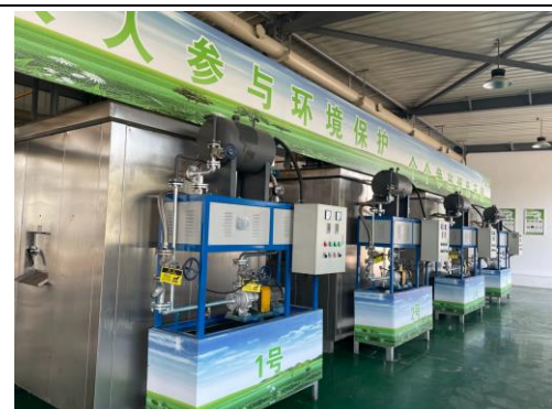
淳溪街道餐厨垃圾处理项目内部设备
