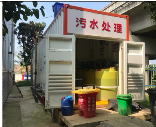
薛城片区生活垃圾转运站污水预处理站
